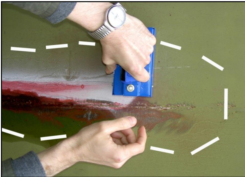
Рисунок 1.23 – Пример выявления зоны пораженного металла вокруг трещины при проведении технического диагностирования вышки типа 40В6М с применением структуроскопа (коэрцитиметра) КРМ-Ц-К2М. Положение датчика КРМ-Ц-К2М на снимке – поперек направления прокатки профиля листа
