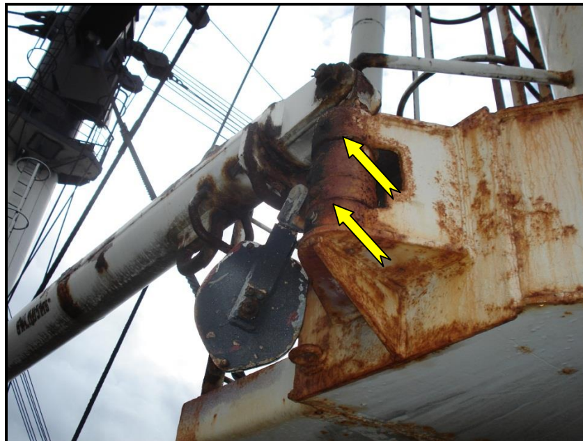
Рисунок 1.8 – Фрагмент шарнирного устройства опоры стрелы килектора. Пример коррозионного повреждения
